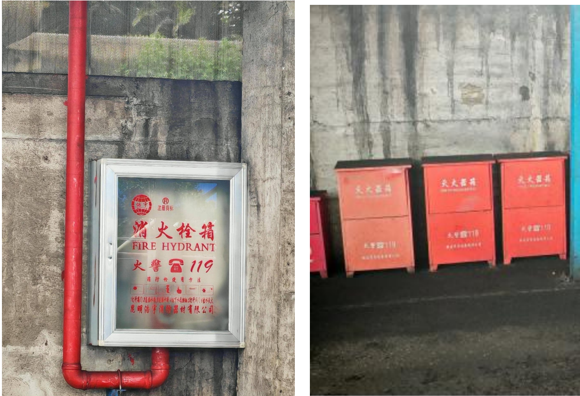
附图 1-7 消火栓、灭火器
